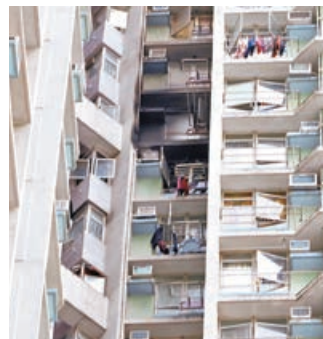
涉事單位外牆嚴重熏黑。
