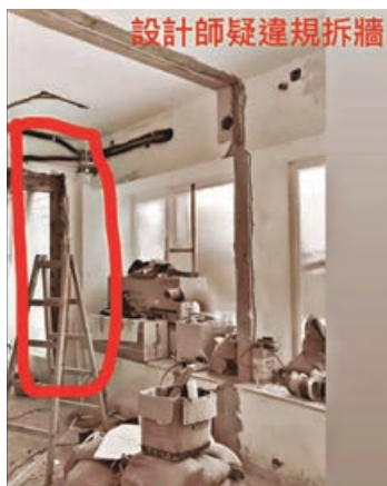
■有單位疑拆除主力牆。
