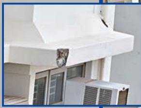
■遭雷電劈中的單位，證實窗外石屎簷篷崩毀。
