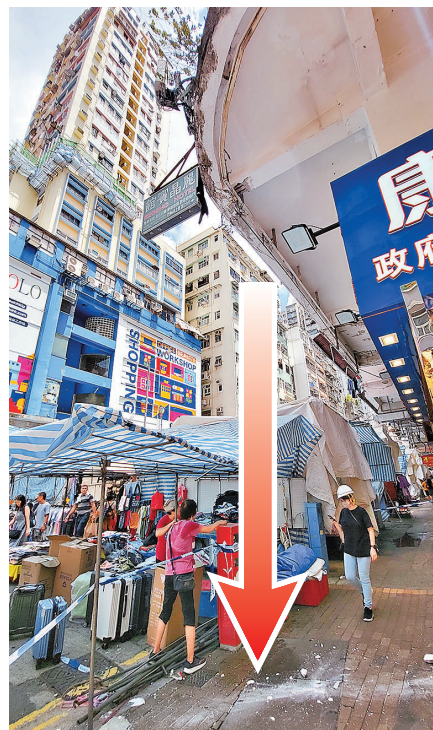
旺角通菜街一幢唐樓外牆石屎移除後墜落地面。
