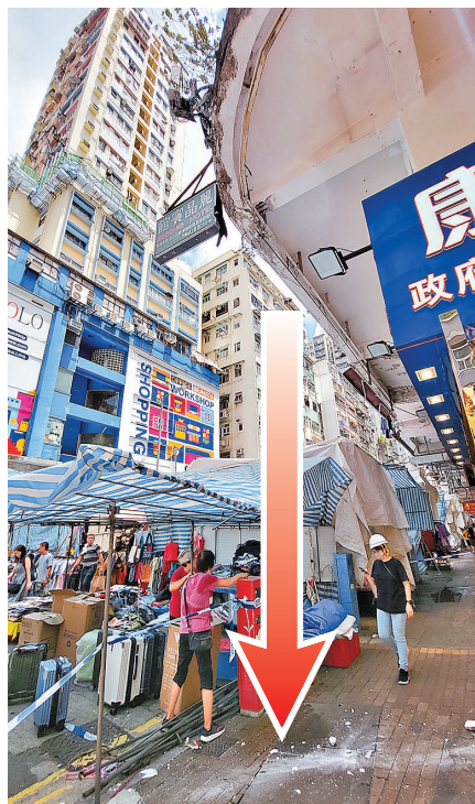
旺角通菜街一幢唐樓外牆石屎剝落後墜落地面。
