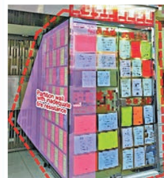
■ 違規在地面樓梯出口處加建構築物。 屋宇署
