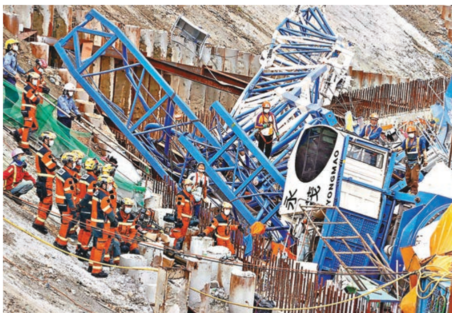
■安達臣道地盤去年9月發生工業意外，有天秤倒塌導致3死6傷。
