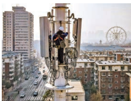
■工作人員正在基站調試設備。資料圖片
