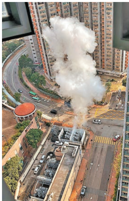
■變電站內大量白煙升上半空，遠近皆見。
