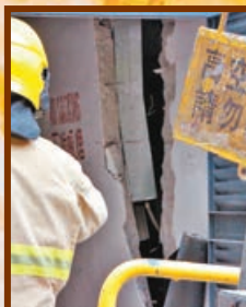
電錶房內部牆身被炸塌、鋼筋外露。
