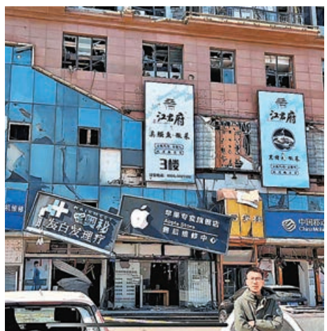
■ 爆炸現場對面商業街的窗戶被震壞。
