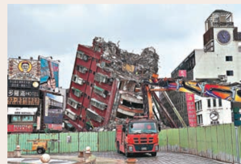
■花蓮天王星大樓在地震中倒塌後，當局持續進行拆除工作。
