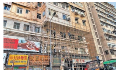
舊區大部分樓宇都有老化問題，需要復修。
