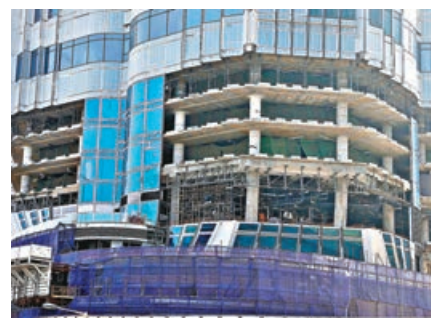
■高鐵西九龍站上蓋地盤發生致命工業意外。
