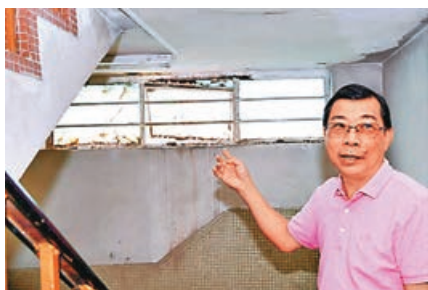
■楓蔭樓業主指大廈尚有多處待修。
