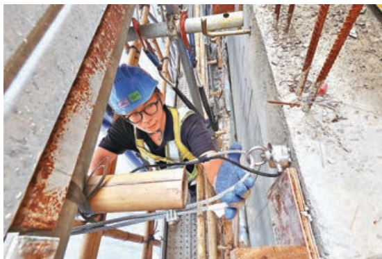
■智能棚架監測系統已在古洞北地盤完成測試。
