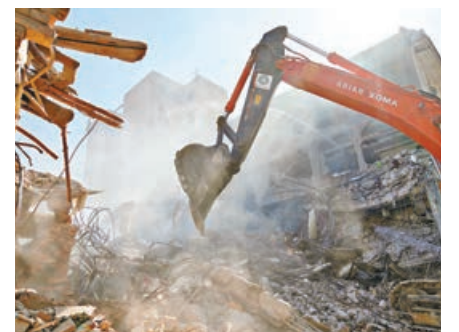
■ 在德黑蘭受襲後，一台挖土機正在清理被炸現場的瓦礫。美聯社
