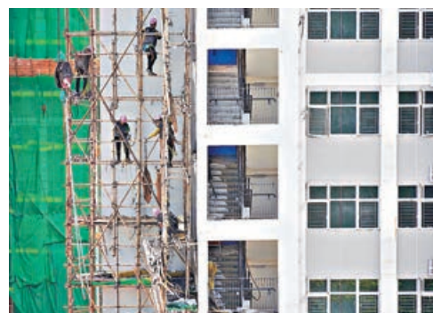
樓宇須定期進行大維修。資料圖片
