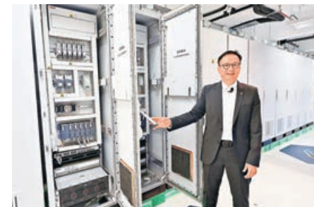
■梁志添介紹鐵路所涉及機電設備眾多。
