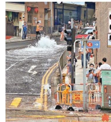
■水務署加快更換舊水管，減少滲漏風險。 資料圖片
