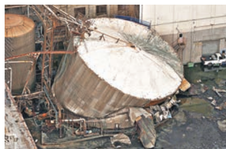
■造紙廠化學品儲槽破裂後損毀嚴重，仍有多人失蹤。 路透社
