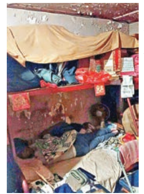
■單位裝修殘舊並放滿通屋雜物。
