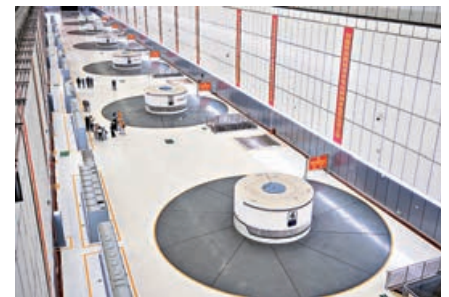
■四川兩河口水電站地下發電廠房。
