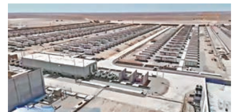
■阿曼一座 400 千伏預製艙變電站成功送電。
