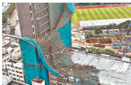
■棚架連同防護網倒塌在毗鄰大廈天台。
