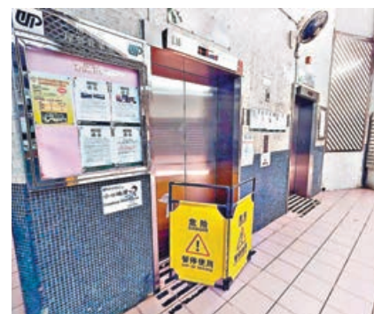
■臺日電梯被揭未按規格安裝升降機門框組件。
