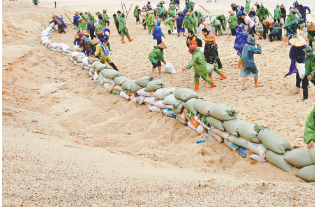
二十九日，受「鳳凰」影響，福建省漳浦縣深土鎮海堤出現三十多米長的坍塌。圖為深土鎮軍民正在加固海堤 (新華社)
