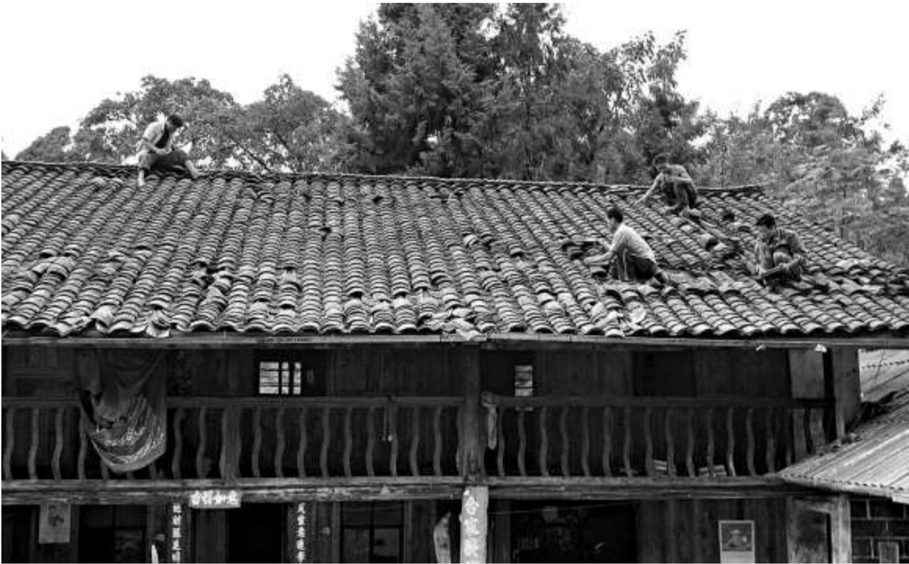
▲雲南省盈江縣發生地震，截至20日16時，盈江地震導致15個鄉鎮1777戶8515人受災。圖為盈江縣蘇典鄉茅草寨村房屋在地震中受損情況（新華社）
