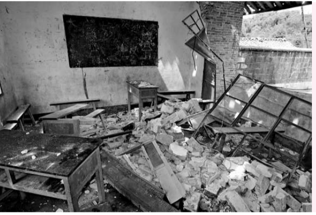
▲雲南省盈江縣發生地震，截至20日16時，盈江地震導致15個鄉鎮1777戶8515人受災。圖為盈江縣蘇典鄉茅草寨村房屋在地震中受損情況（新華社）
