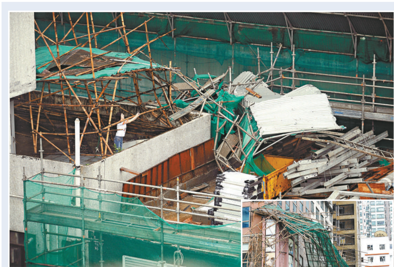
▲深水埗塌棚架壓向對面大廈天台 (林良堅攝)
