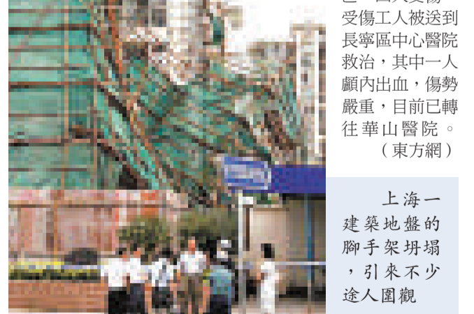
上海一建築地盤的腳手架坍塌，引來不少途人圍觀。
