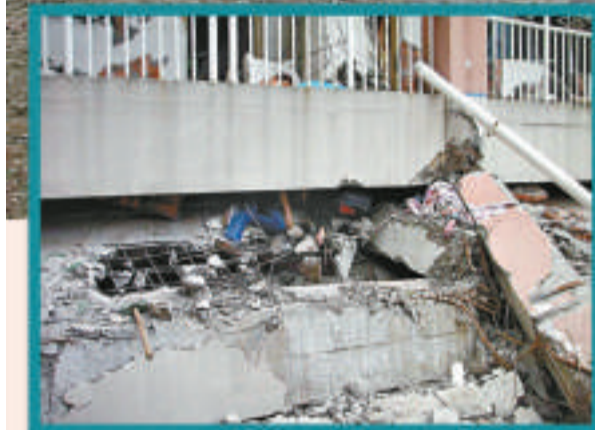
地震波由地面衝出，令北川中學首兩層樓被壓碎，數名學生走避不及喪生
