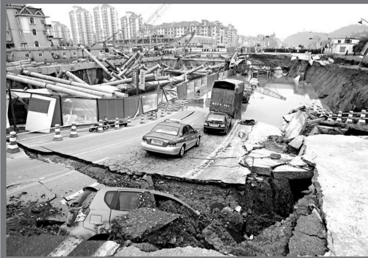
經初步核實，杭州地鐵工地塌陷事故中已有四人死亡，17人失蹤，事故原因正在進一步查明中。圖為塌陷現場有汽車被埋。（美聯社）
