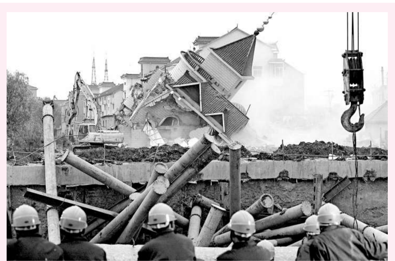
杭州地鐵工地塌陷事故遇難人數已增至5人。圖為受地陷影響的周邊建築物需要實施引爆拆毀(路透社)
