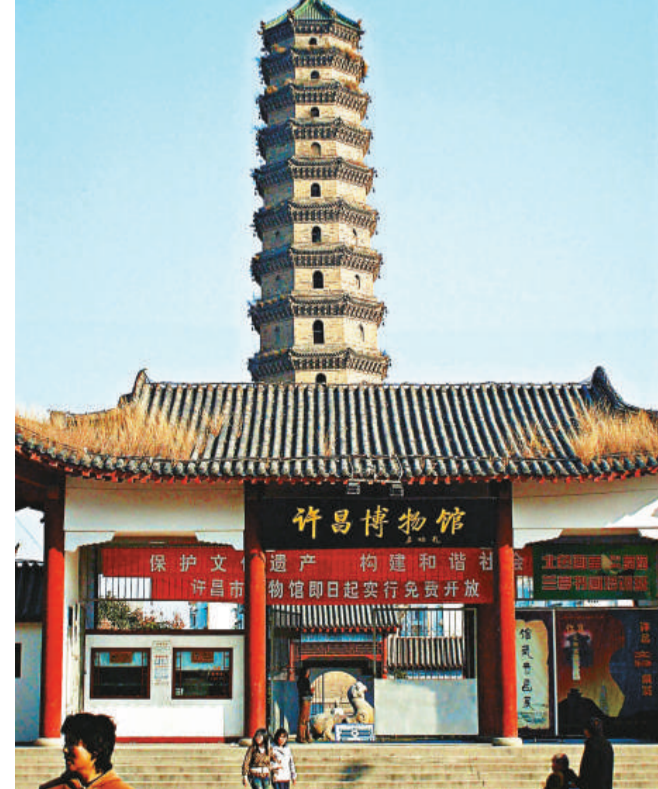
擁有中國風水第一塔、河南明代磚塔之首等眾多「頭銜」的許昌市文峰塔的斜偏工程二十五日進入了第二天。該塔始建於四百年前，近十四年來均傾斜度是意大利比薩斜塔年均傾斜度的十倍。圖為文峰塔塔身已經嚴重傾斜 (中新社)
