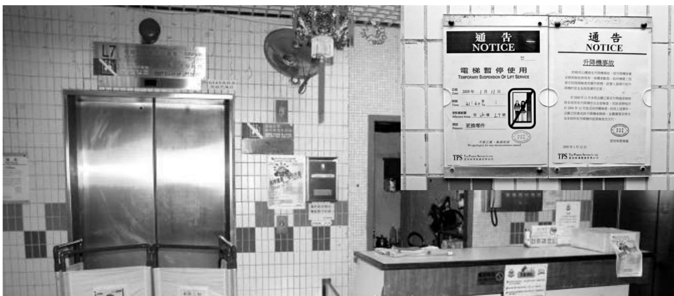
▲馬鞍山恆安邨一部升降機，四條鋼纜其中一條昨晚突然斷裂。圖為出事電梯。
