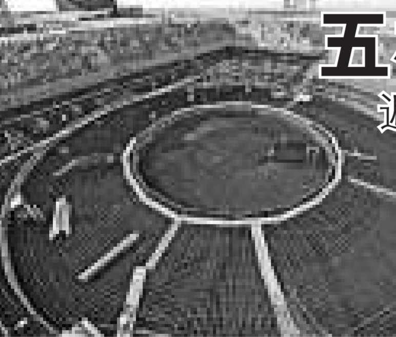
浙江三門核電項目一期工程1號機組核島基礎3月14日施工現場 (資料圖片)
