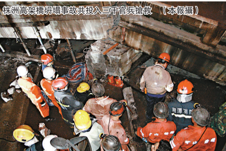
株洲高架橋塌橋事故共投入三千官兵搶救 (本報攝)
