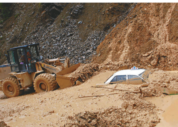
貴州省榕江縣9日遭強降雨，境內321國道邊坡多處大面積坍塌，200多輛汽車被阻；一輛的士被泥石流掩埋，幸未造成人員傷亡。圖為榕江公路路政人員將遇險車輛救出。（新華社）
