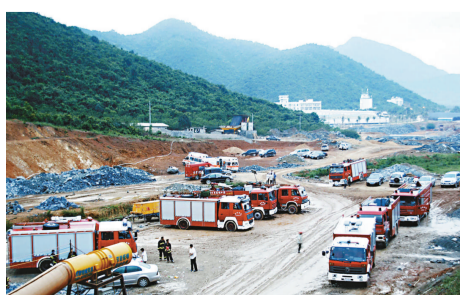
海南省三亞市繞城高速公路正在施工的迎賓隧道4日發生塌方事故，施工方長沙路橋公司9日搶先在長沙召開記者會，宣布事故原因為「突發性自然災害事件」（資料圖片）
