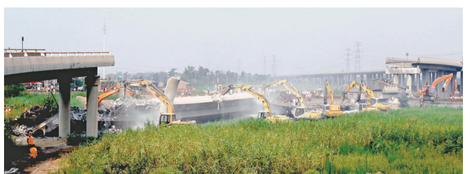
▲十五日拍攝的津晉高速公路匝道橋坍塌事故現場 (新華社)
