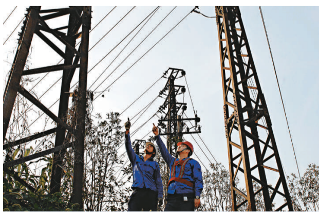
安徽地區連續多日持續高溫，合肥電網也多次刷新用電負荷紀錄。為應對夏日用電高峰，合肥市供電公司積極組織工作人員監視市內各條重要供電線路
