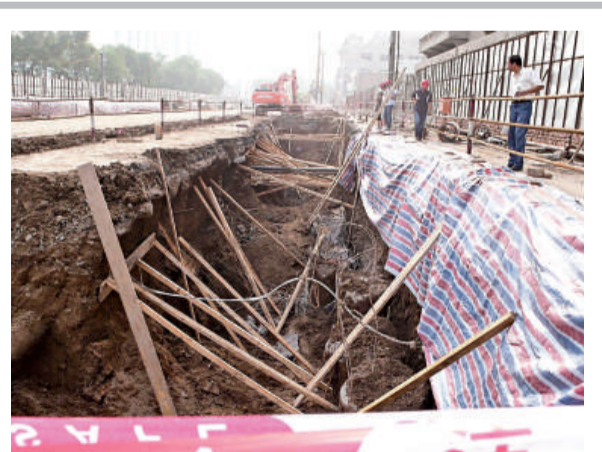
西安地鐵塌方現場 (本報攝)
