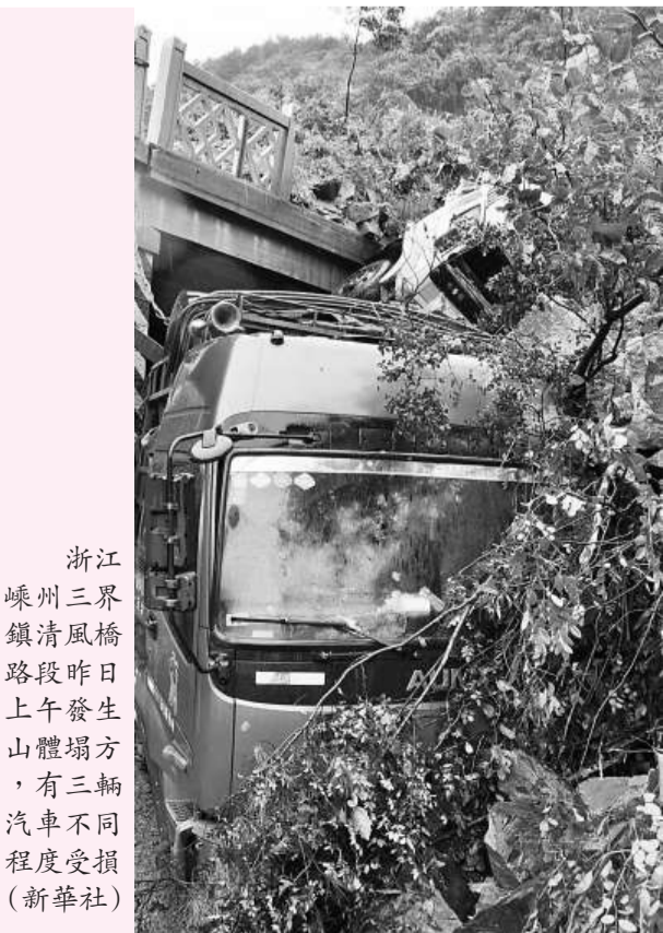
浙江嵊州三界鎮清風橋路段昨日發生山體塌方，有三輛汽車不同程度受損 (新華社)
