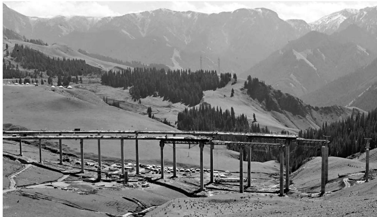
高速公路躍天山 在風光秀美的新疆西天山果子溝，巍峨的鋼筋混凝土主塔拔地而起，與峻拔的天山遙相呼應，新疆建設史上技術要求最高、施工難度最大的公路賽里木湖—果子溝口（簡稱「賽一果」）高速公路正在加緊建設中。「賽一果」高速公路是新疆第一條貫穿天山並實現橋樑隧道相連的高速公路，全長五十六公里，為連雲港—霍爾果斯國家高速公路的一部分。整條公路將在二〇一〇年通車。 (新華社)
