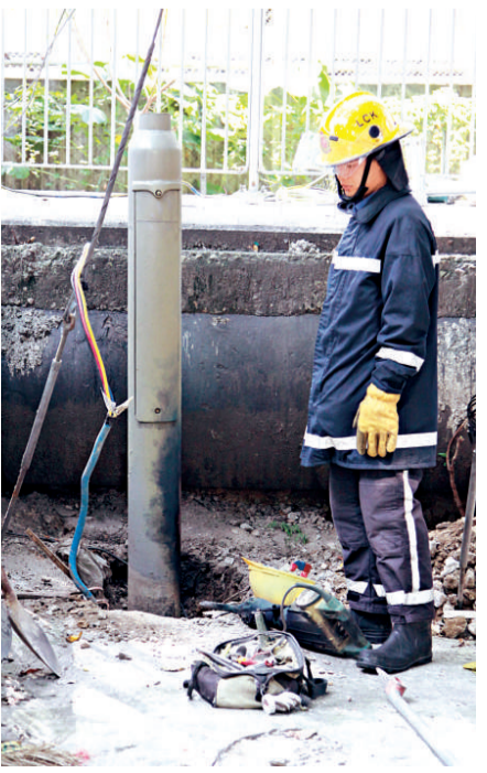
▲電力公司工人用風炮鑿地，擬安裝照明燈柱時，誤觸地底電纜發生「爆炸」
