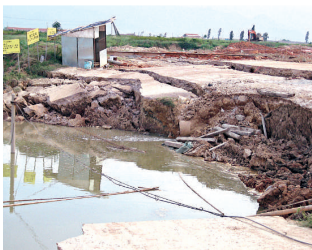
在建江肇高速公路沙浦段的施工地段二日出現塌陷，未收到人員傷亡報告。初步調查，地面塌陷是施工打樁機穿地下溶洞所致 (中新社)
