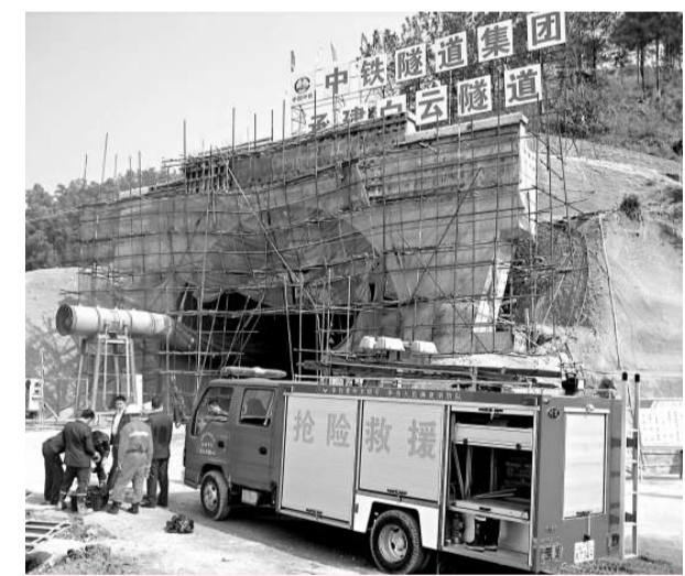
▲發生塌方事故南廣高鐵廣東白雲隧道
