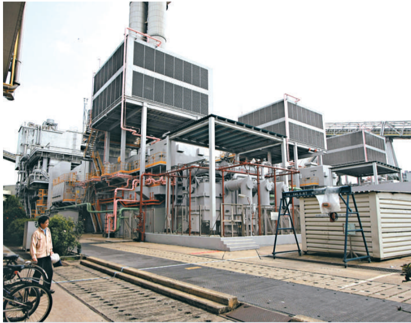
港燈在南丫島電廠投資二千多萬裝設太陽能發電 (資料圖片)
