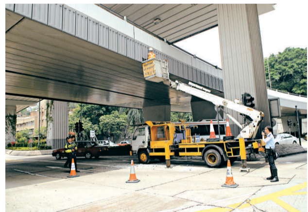
▲當局事後檢查受損的天橋橋墩
