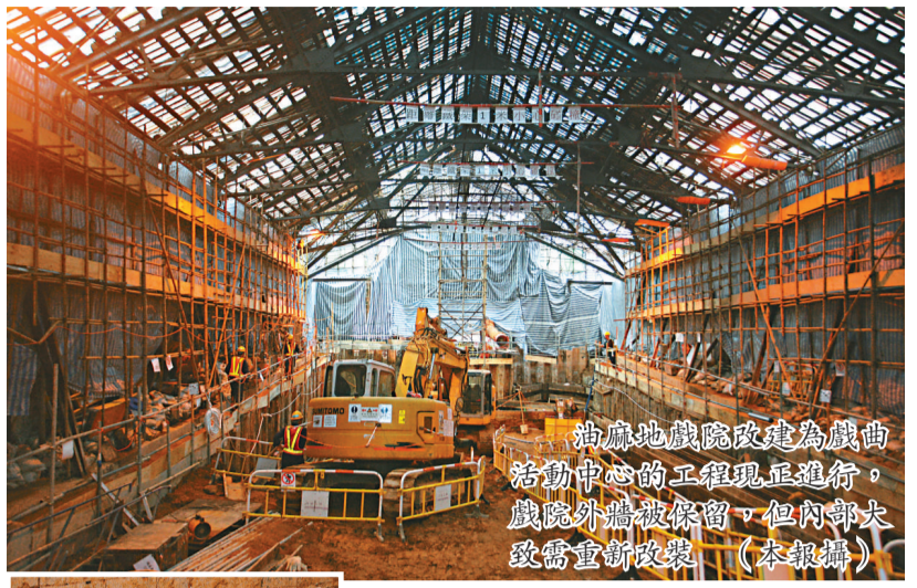
油麻地戲院改建為戲曲活動中心的工程現正進行，戲院外牆被保留，但內部大改需重新裝修。（本報攝）
