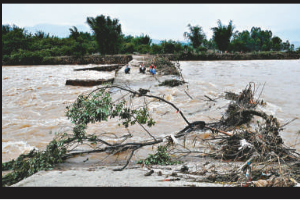
▼連日暴雨山洪暴發，導致廣東翁源民治、游溪、小鎮等3個村莊路橋被毀，8000多村民出行困難 (中新社)
