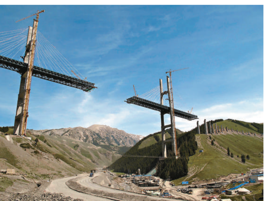
▲正在緊張建設中的賽果高速公路（賽里木湖至果子溝） 新華社
